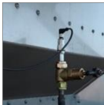
Sensor Transdutor de pressão instalado
