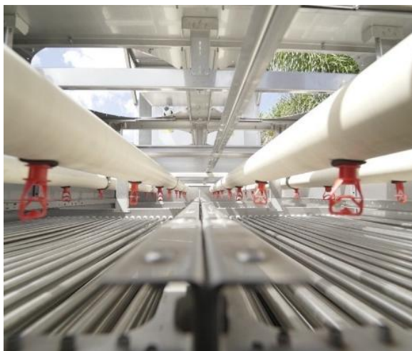
Figura 20 – Quatro ramos internos e distribuição dos bicos aspersores.
