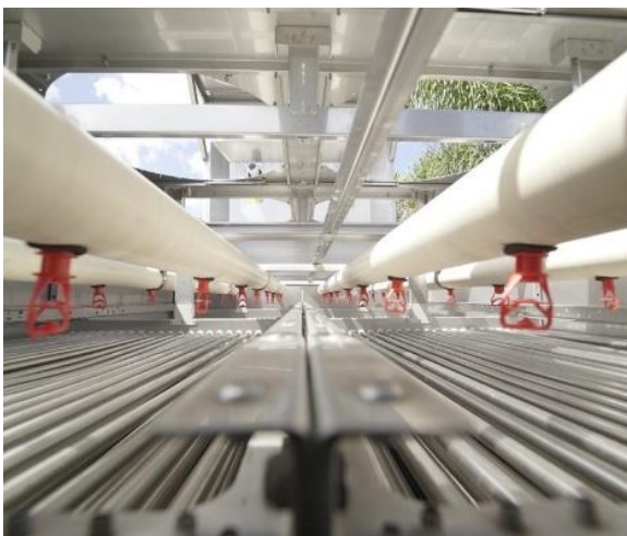
Figura 29 – Quatro ramos internos e distribuição dos bicos aspersores
