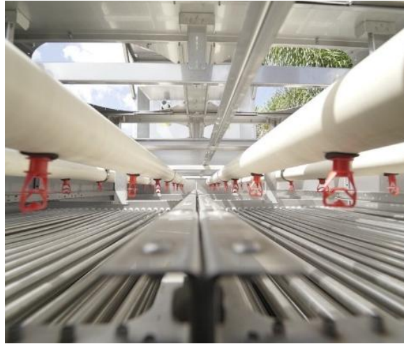
Figura 18 – Quatro ramos internos e distribuição dos bicos aspersores
