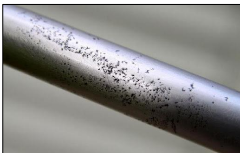
Figura 1 - Corrosión por agujeros
